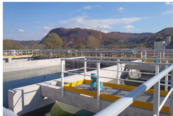
Obr. 22 Objekt ČOV a.s.
