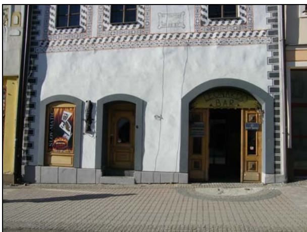
41. Dolná 20. Neprimeraná veľkosť otvorov v mieste pôvodných okien, nevhodný tvar výkladov so segmentovým záklenkom.
