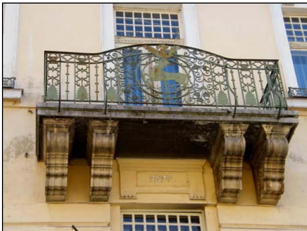
62. Námestie SNP 8, administratívna budova Štátne lesy. Mreža balkóna na bočnej fasáde, rok 1912.
