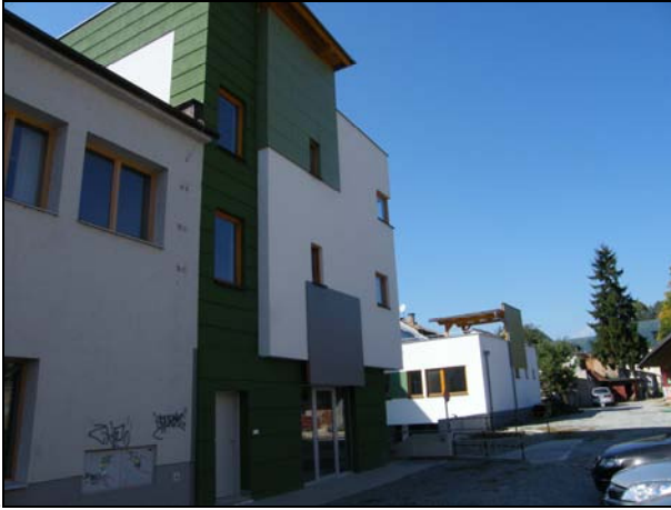
120. Horná Strieborná 15, meštiansky dom, pohľad z juhovýchodnej strany z dvora domu na Námestí SNP 16. Dostavba dvorového krídla domu na Námestí SNP 14 a prieluky. Nevhodné architektonické riešenie, hmotová skladba, výškové riešenie, spôsob zástavby parcely, farebné riešenie.
