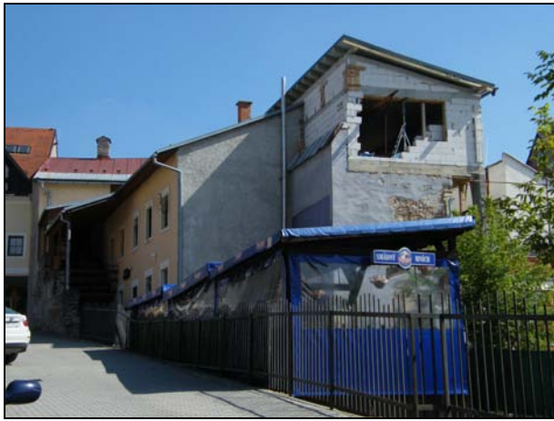
99. Dolná 22, meštiansky dom. Nevhodná nadstavba dvorového krídla, predsunutie horného podlažia pred líce fasády, kvôli kompenzácii hmoty zastrešenie len plytkou pultovou strechou.
