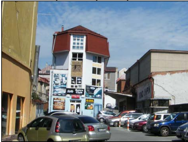
86. Námestie SNP 6, dvorové krídlo meštianskeho domu. Nadstavba dvorového krídla, nevhodná „mansardová“ strecha.
