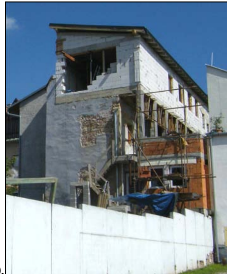
100. Dolná 22, meštiansky dom. Pohľad zo severozápadu, viditeľné nevhodné konštrukčné riešenie s nosnými stĺpmi, uzatvorenie dvora priečnou stavbou.
